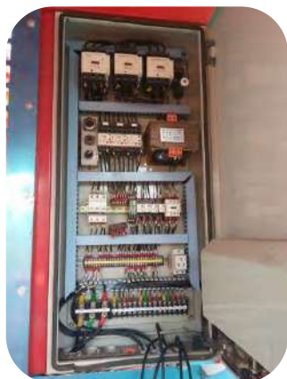
Блок с PLC-управлением
